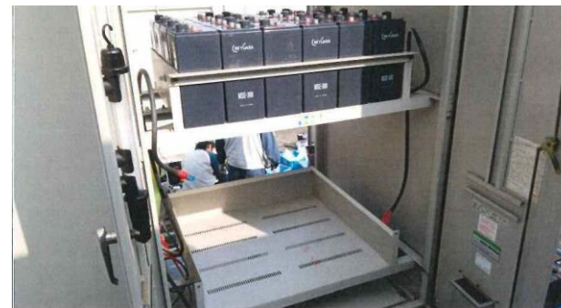
蓄電池組み込み
