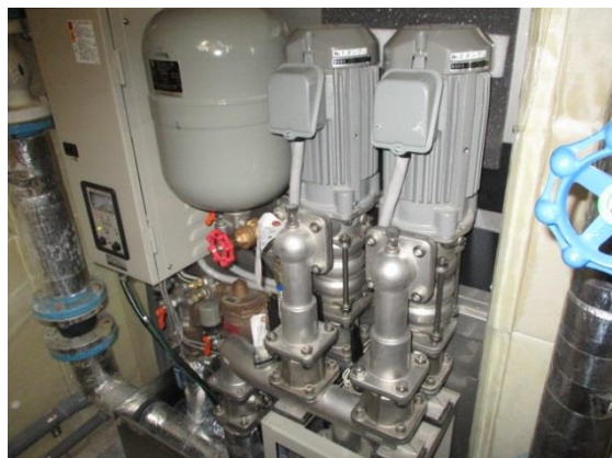
給水ポンプユニット作業前
